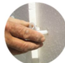
1-Forare polistirolo e muro
